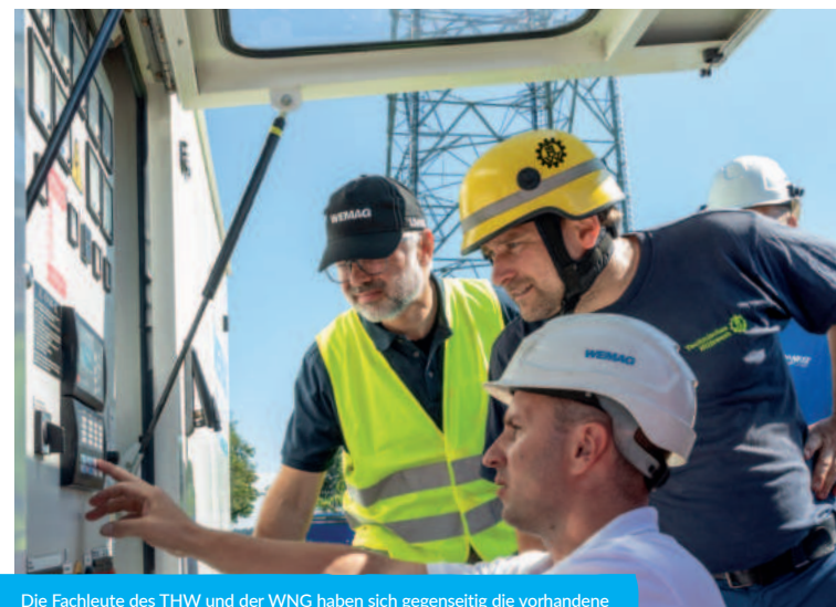
Die Fachleute des THW und der WNG haben sich gegenseitig die vorhandene Technik vorgestellt sowie Bedien- und Schalthandlungen durchgesprochen.
