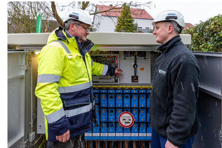
Thomas Junghans, Netzdienststellenleiter bei der WEMAG Netz GmbH und Servicetechniker Domenik Kucz (v.l.) prüfen die Technik in der neuen digitalen Ortsnetzstation in Wittenburg.
