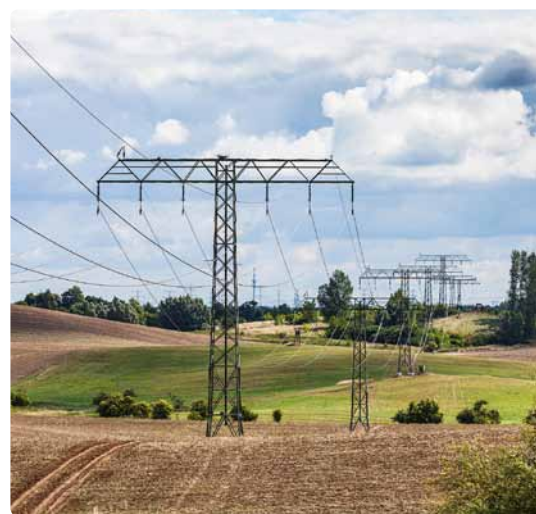
Für eine sichere und stabile Energieversorgung investieren wir in den Ausbau und die Instandhaltung unseres Verteilnetzes.
