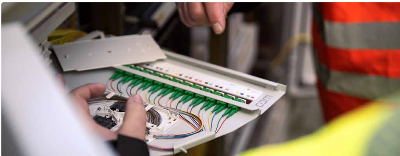
Haarfeine Glasfasern für superschnelles Internet für mehr als 10.000 Kunden im Landkreis Nordwestmecklenburg
