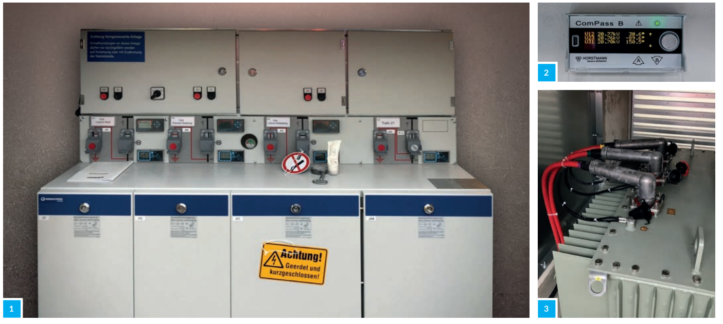
(1) Fernsteuerbare Mittelspannungsschaltanlage, (2) Messwerterfassung Mittelspannung inklusive Fehlererkennung, (3) Mittelspannungs-/Niederspannungs-Transformator
